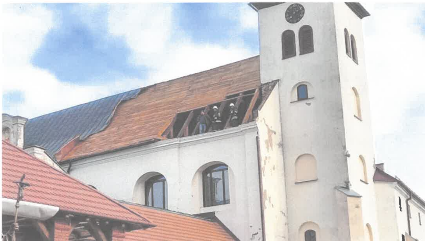
Widok połaci północnej przed zabezpieczeniem szkód.
